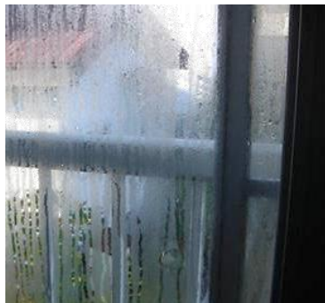
<施工前> 朝方 結露がひどい
