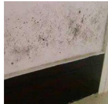
断熱性の悪い内装による 結露
